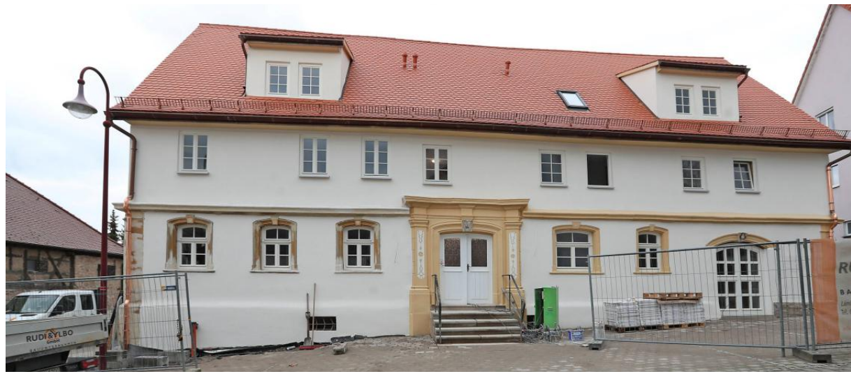
Der ehemalige „Ochsen“ in der Eschenauer Kirchgasse ist herausgeputzt. Die Tür- und Fensterleibungen werden aufgearbeitet. Neu sind Sprossenfenster und Gauben. Vor dem Gebäude und seitlich sind sechs Parkplätze. Fotos: Andreas Veigel (3)/privat
